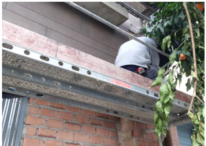
Recreación de la postura que debió adoptar el trabajador durante la tarea (imagen tomada en otra planta del andamio).
