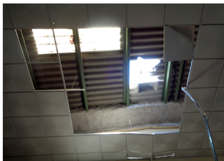
Lugar del accidente. Se aprecia la rotura de las placas de fibrocemento de la cubierta y del falso techo de escayola tras la caída desde altura.
