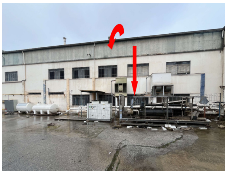
Zona de la cubierta inclinada desde donde el trabajador se precipitó al exterior de la nave.
