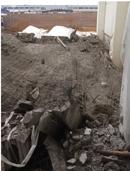
Zona hormigonada del forjado colapsado.
