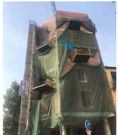
Fachada del edificio y montacargas desde el que se produjo la caída del trabajador.
