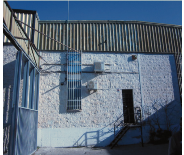
Exterior de la nave industrial donde ocurrió el accidente mortal durante trabajos en la cubierta.
