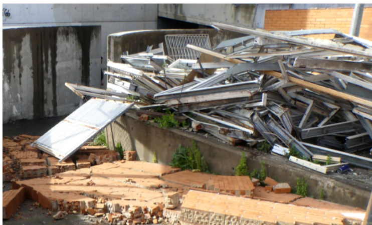
Imágenes del muro tras el derrumbamiento y material de acopio acumulado.
