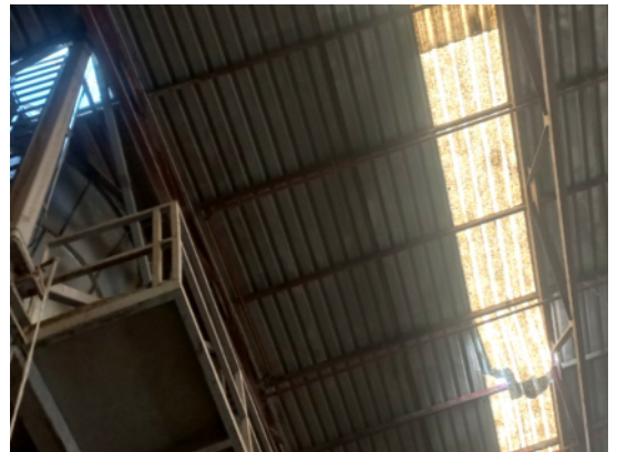
Placa de policarbonato que forma parte de la cubierta de nave industrial y desde donde se produjo la caída.
