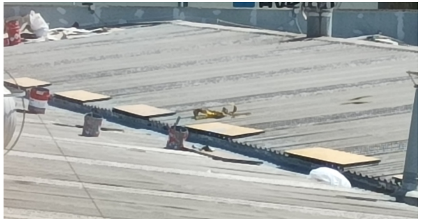
Lugar del accidente. Se aprecian los cubos impermeabilizantes y los tableros de encofrado para conformar un pasillo de tránsito a todo el largo de la cubierta.
