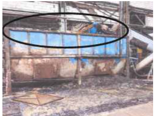
Para realizar la apertura de la balsa había que subirse encima sobre la placa que colapsó.
