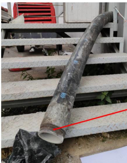
Extremo de la manguera flexible que golpeó al trabajador.
