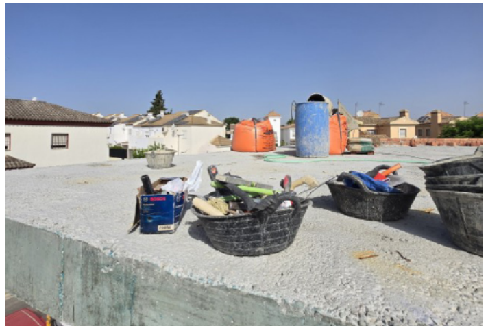
Azotea del accidente con materiales y el murete al fondo. Sin protecciones colectivas.
