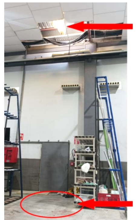
Interior de la nave donde se produce la caída, con el lucernario roto y la zona de impacto.
