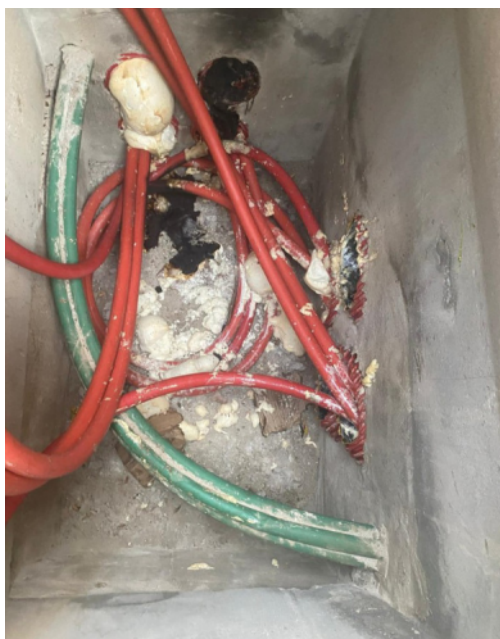
Estado del interior de la arqueta tras el accidente, con las canalizaciones eléctricas ya selladas con espuma de poliuretano y las marcas del fogonazo que alcanzó al trabajador.
