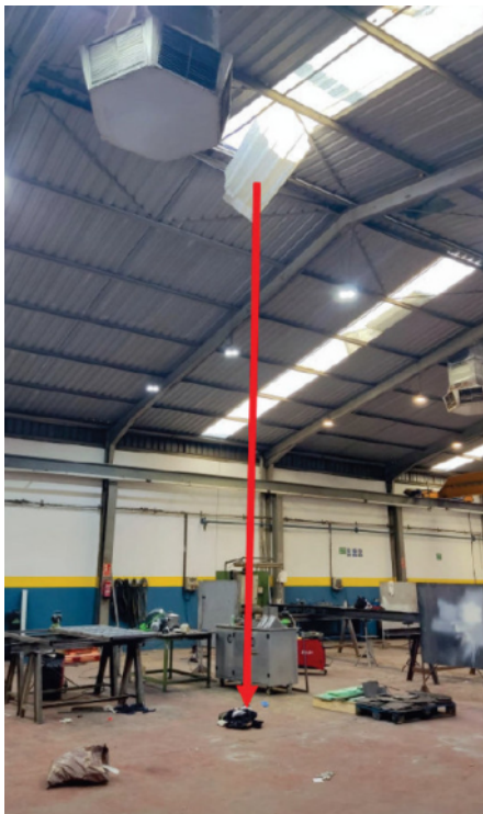
Trayectoria de caída del trabajador accidentado.
