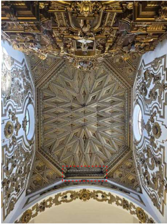
Figura 1. Artesonado del presbiterio de la iglesia de San Juan Bautista en Coin. Se señala en rojo la zona dañada y deteriorada del arrocabe. Visita del día 28 de noviembre de 2025.
