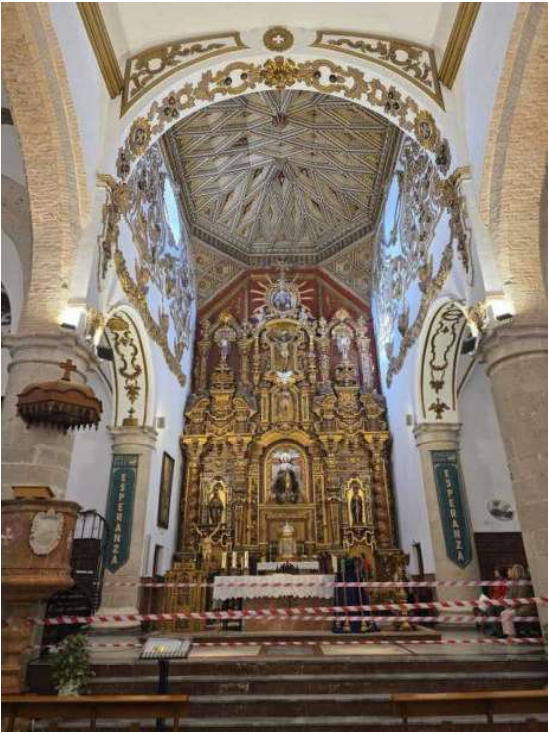
Figura 2. Zona acotada con cinta de señalización bajo el arco toral. Visita del día 28 de noviembre de 2025.
