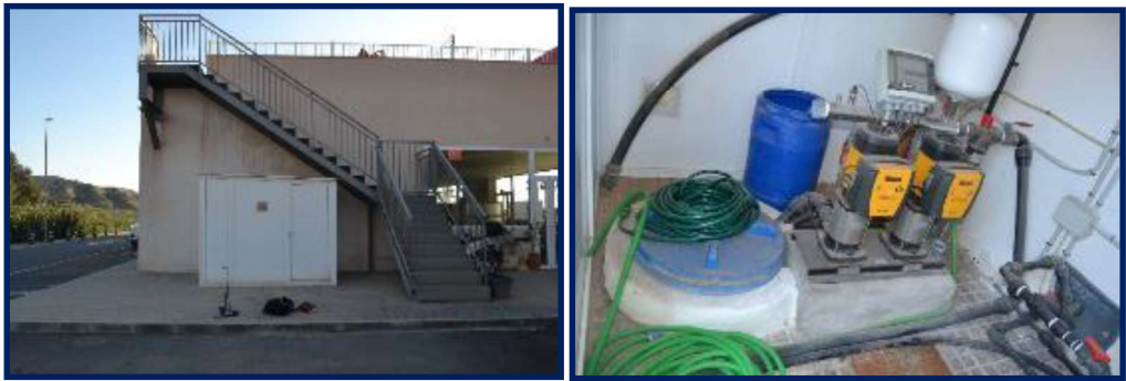
Tratamiento y cloración del agua de abastecimiento del pozo de la E. S. Las Jareas
