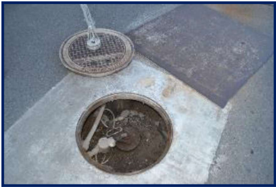
Pozo de abastecimiento de la estación de servicio Las Jareas (Motril)
