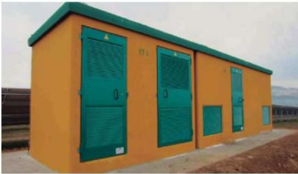
Ilustración 23. Estación de Potencia Selma CTA
