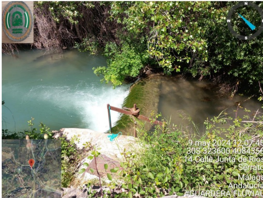
Figura 1: Imagen del informe de guardería (9 de mayo de 2024) del azud en río Guadalteba con compuerta y arqueta para captación de agua, en la margen izquierda del cauce, hacia el lado norte, al inicio de la acequia del Cascajoso o de La Ventilla
