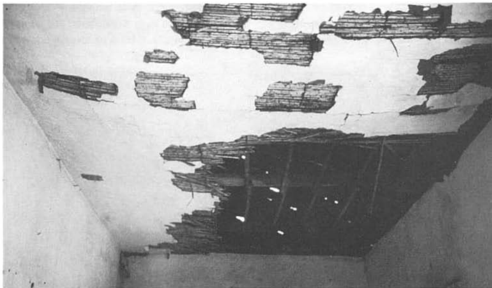
Deterioro en cielo falso por contracción del material.
