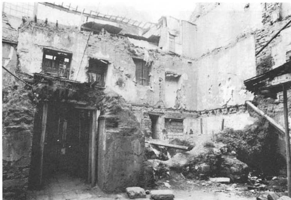
Centro Histórico de Quito. Estado de la Casa de los Siete Patios antes de la intervención.
