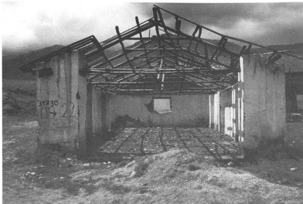
Importancia de la concepción de la estructura de cubierta en los daños de la edificación.
