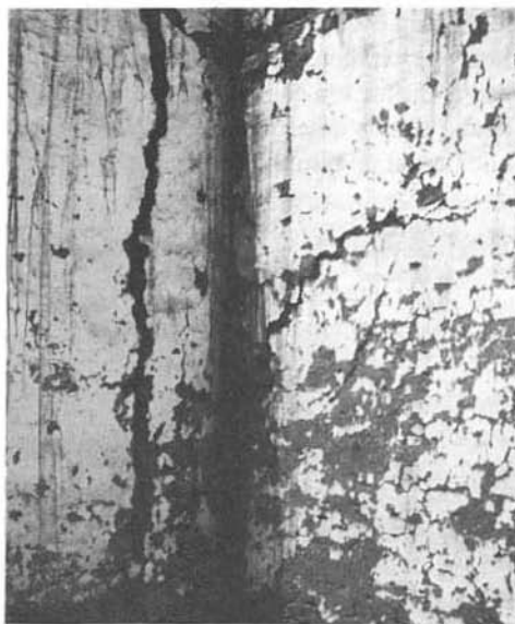
Daños frecuentes en los muros.
