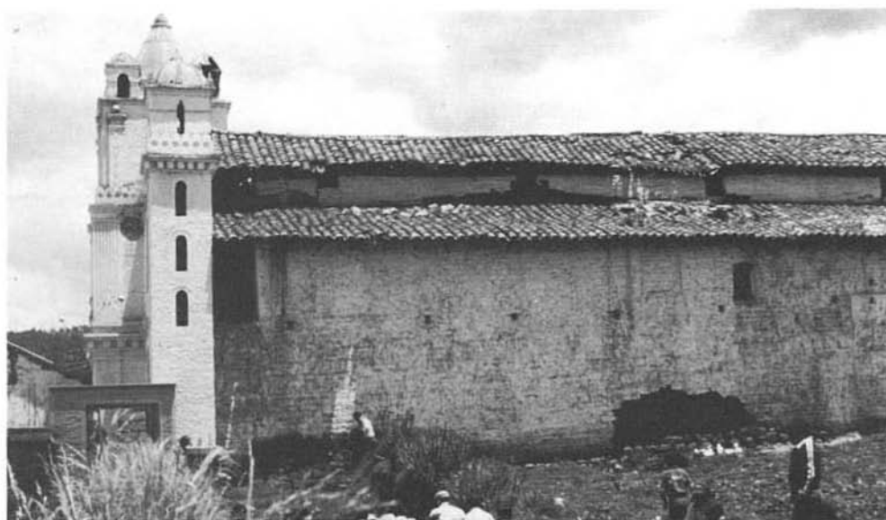
Daños en los cimien- tos en caso de sis- mos.
