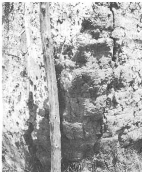
Deterioro por filtraciones (izq.) y daños por carencia de junta sísmica.
