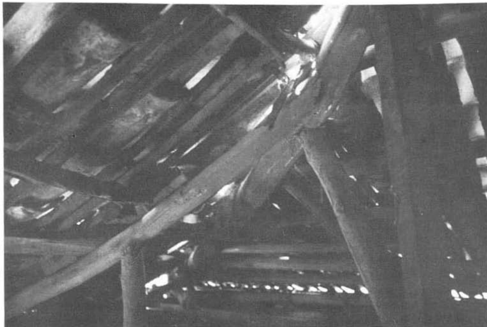
Daños en la estructura, dejan los elementos sueltos a la acción de los sismos.
