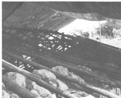
Deterioro por baja resistencia a los esfuerzos de corte.
