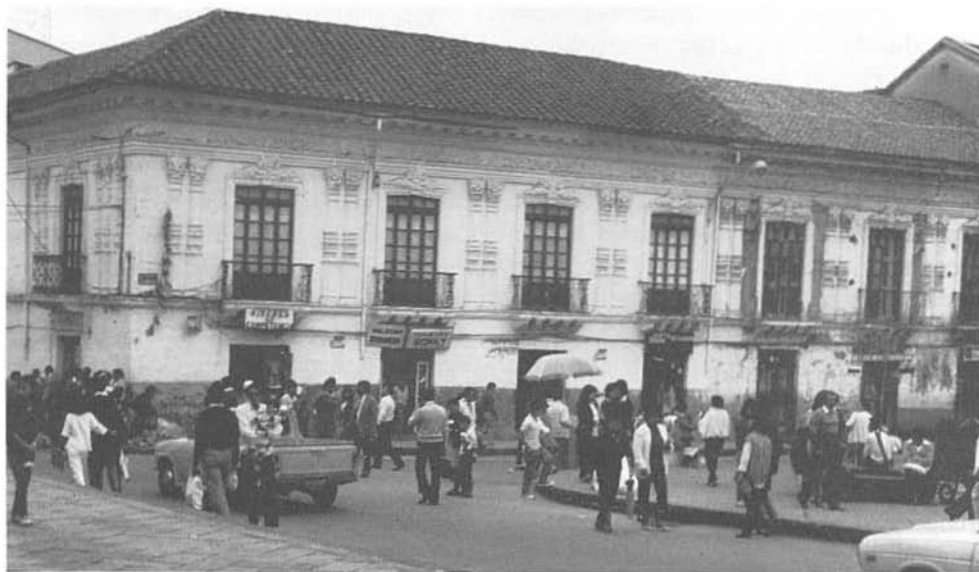
Daños en los muros en movimientos sísmicos por causa de modificaciones en la edificación.
