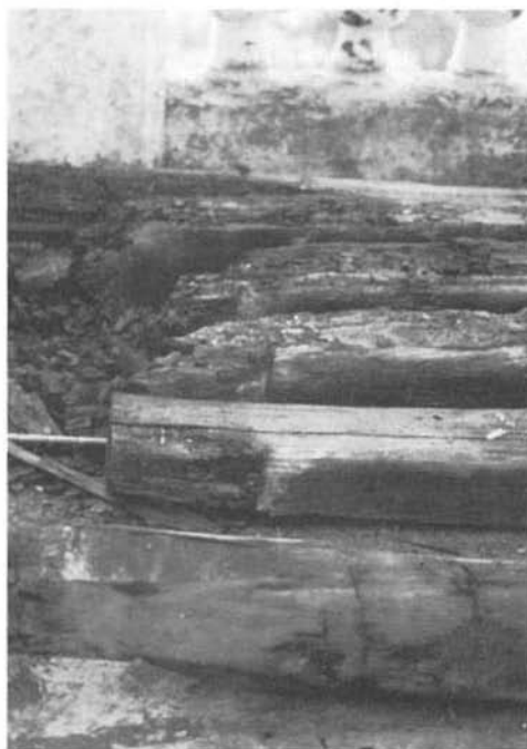
Presencia de hongos y humedad en la madera (izq.). Daños en estructura (der.).
