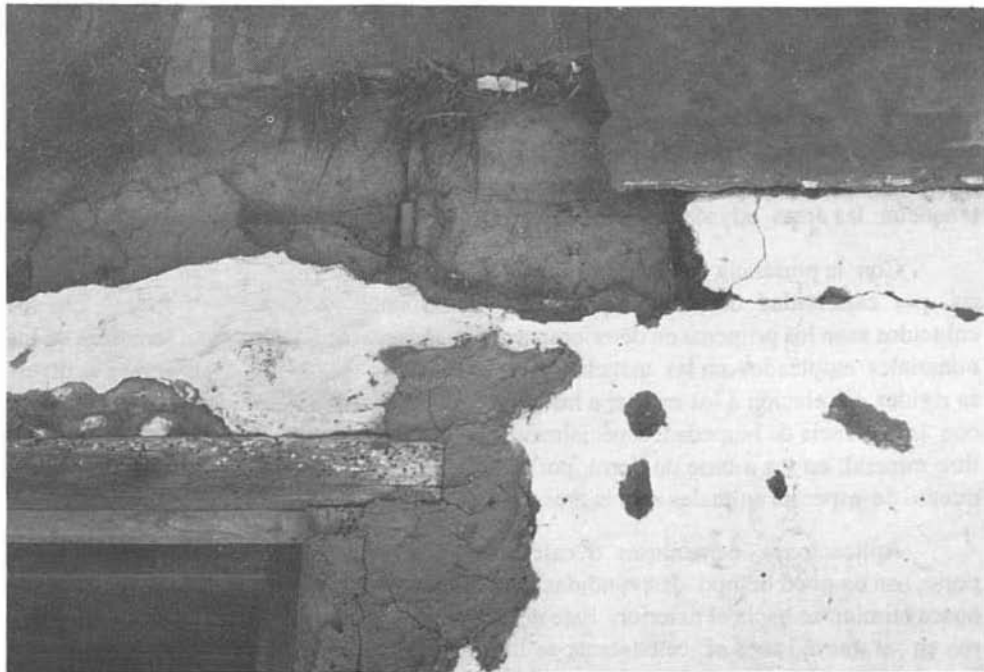
Daños frecuentes en enlucidos y dinteles.
