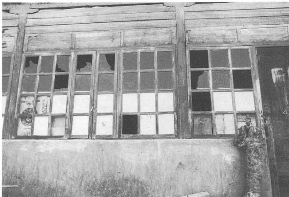
Los entucidos se desprenden por humedad de los muros y destrucción de vidrios por varias causas.
