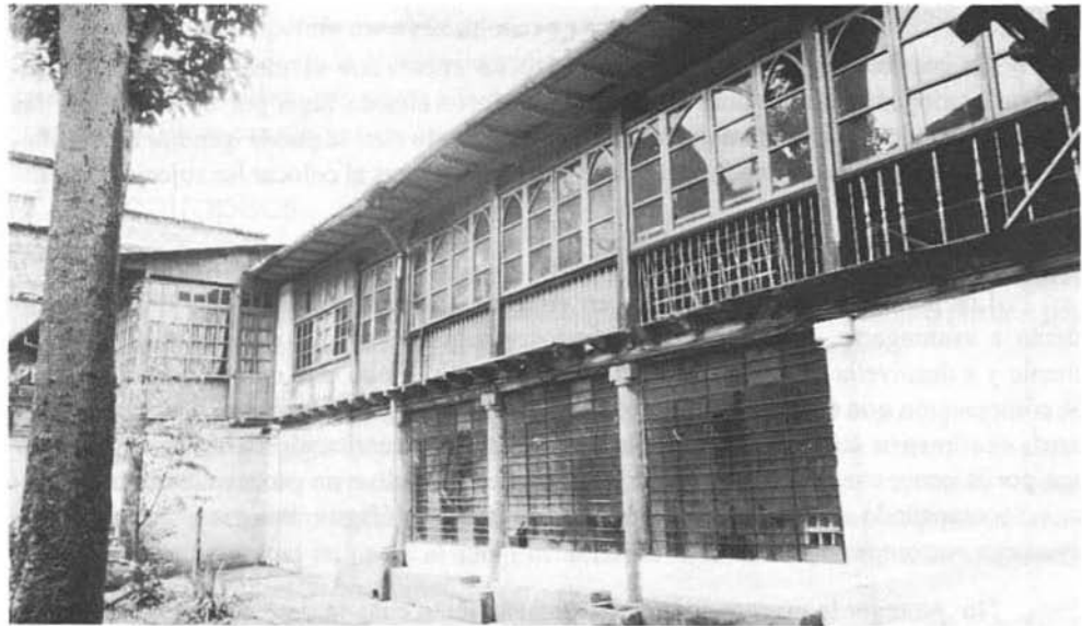
Daños en entrepisos por filtración del agua.
