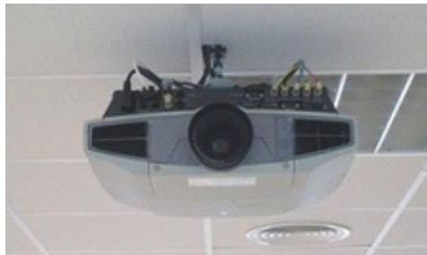
Figura 42: Proyector integrado en sistema multimedia automatizado.
