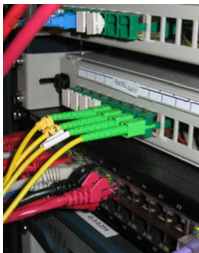
Figura 86: Conexiones fibra óptica a panel.
