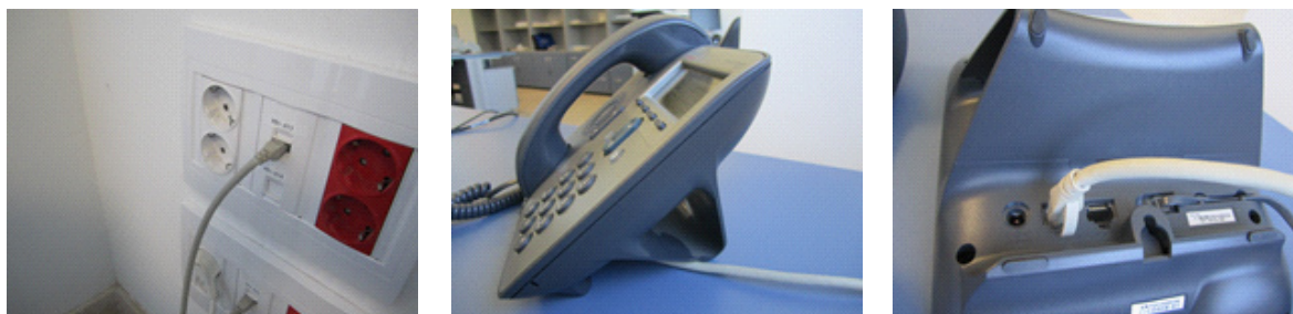
Figura 83: Dispositivo Teléfono IP alimentado por PoE usando latiguillo de cable UTP.
